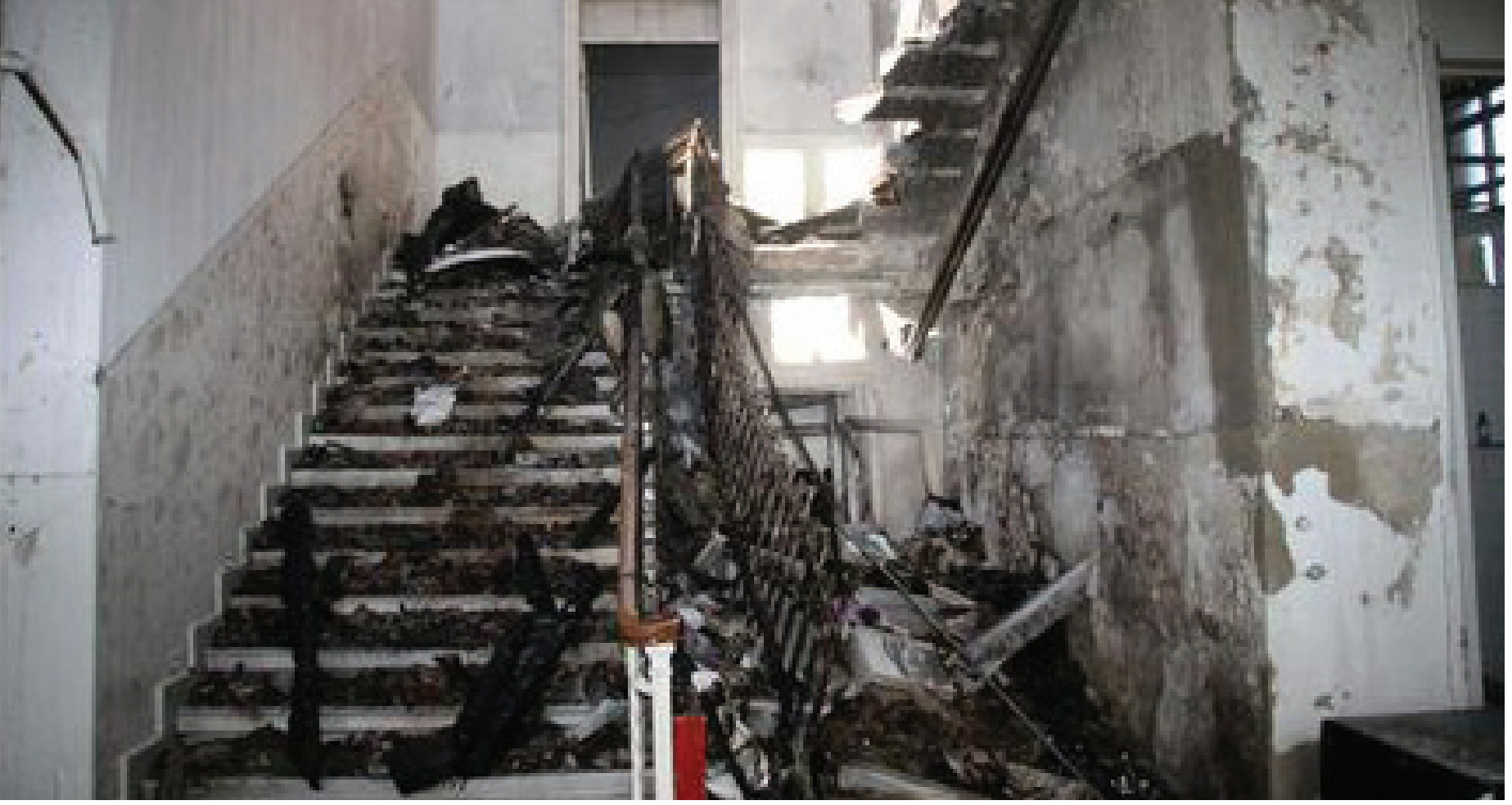
18.10.2009 tarihinde çıkan yangın sonucunda kullanılamaz hale gelen yapı
